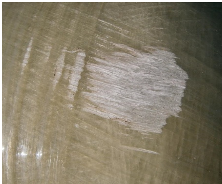
Segni di abrasione sulla superficie del serbatoio
